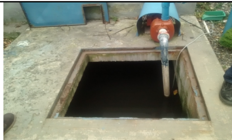
Foto 7. Tanque donde se realiza el proceso de cloración
