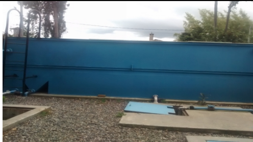
Foto No 6. Tanque de Lodos Activados
